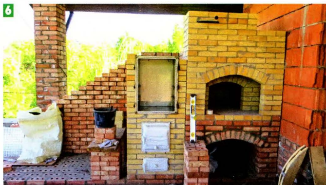
6 Сверху камеры Александр установил коптильный шкаф.
